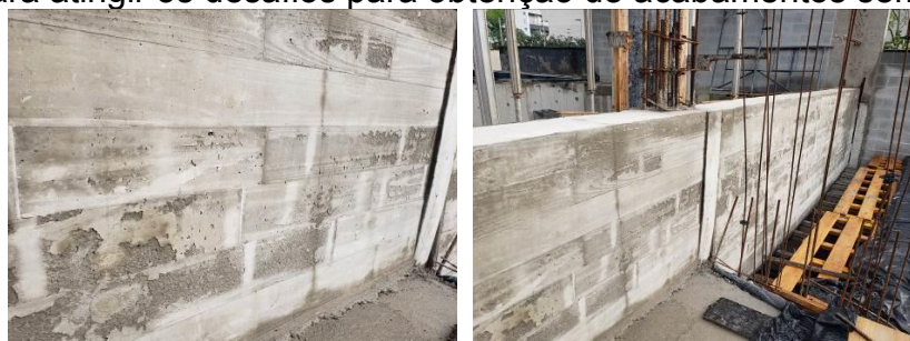
Figura 16: De outra obra, exemplo de concretagem executada por equipe não qualificada, o resultado é cruel, não perdoa falhas e geralmente a única solução é demolir e refazer a concretagem, como foi o caso destas imagens (Fonte: Arquivo S. Takashima)
