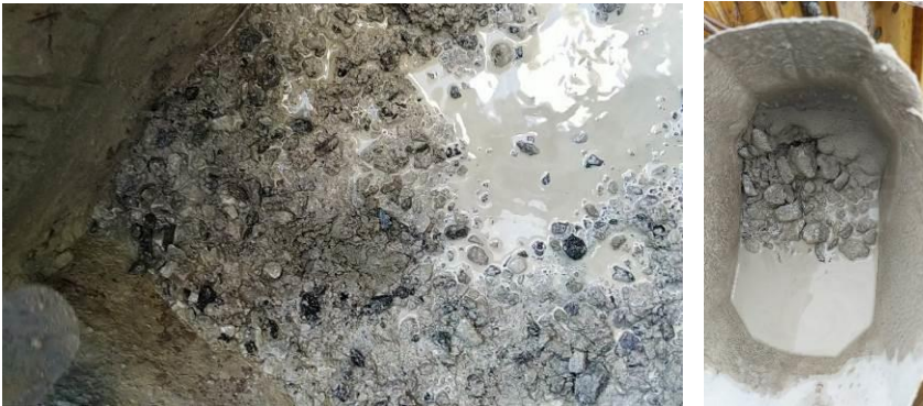
Figura 17: Concreto autoadensável segregado, recusado pelo controle tecnológico da obra – (Fonte: Arquivo S. Takashima)
