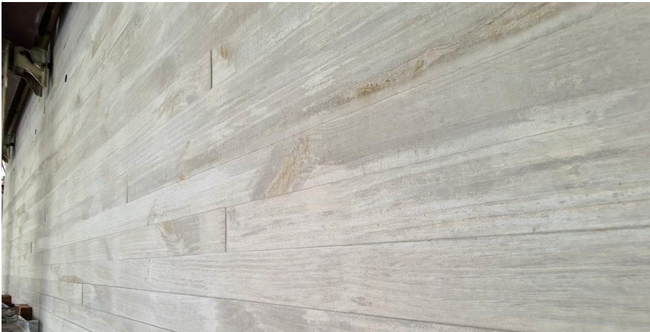
Figura 20: Acabamento do concreto com textura de forma ripada, sem defeitos superficiais, espelhou as marcas das ripas - (Fonte: Arquivo S. Takashima)
