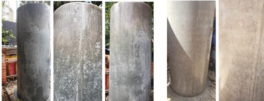
Figura 13: “Mockup” de pilar circular com forma de fibra de vidro - (Fonte: Arquivo S. Takashima)
