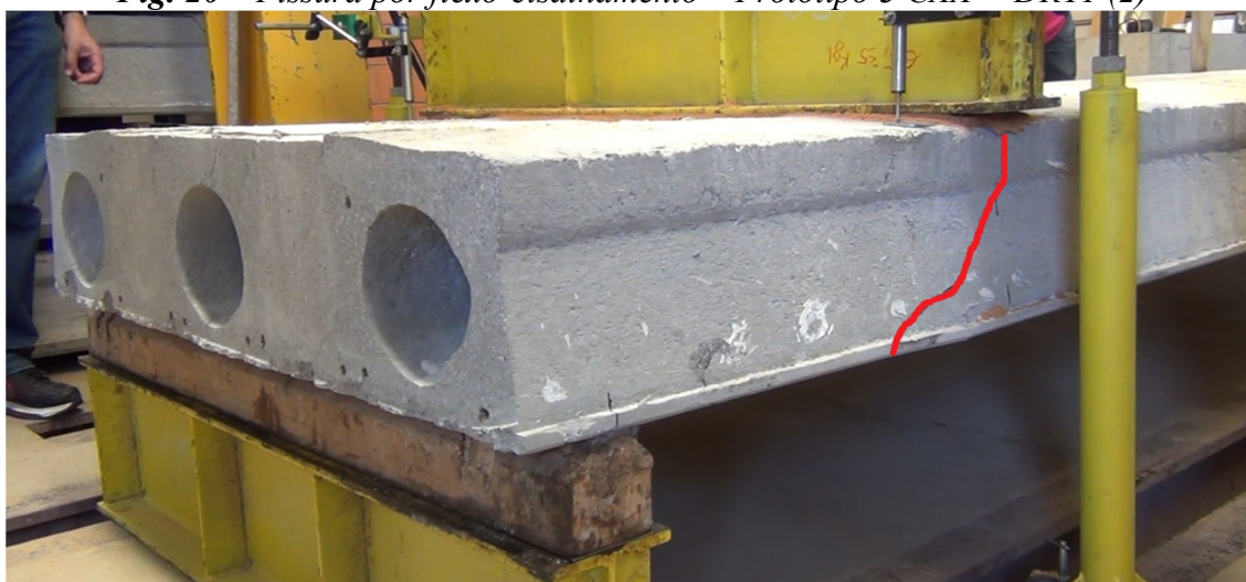
Fig. 20 – Fissura por flexo-cisalhamento – Protótipo 3 CAA + DRYI (2)
